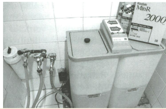
Fig. 6.18 Tanque reservatório e de preparação do revelador e fixador (automixer). Este sistema possui mecanismo para preparação dos químicos para que a diluição seja sempre a ideal e possui também mecanismos de agitação dos químicos, evitando que os cristais se depositem no fundo dos tanques.
