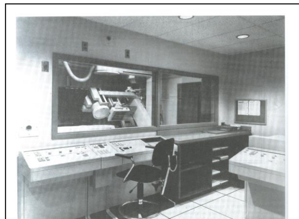
FIGURA 04: A cabine de controle de uma sala de raios-X deve ser blindada para proteger os operadores durante a exposição. A cabine de controle também abriga o painel de controle.
